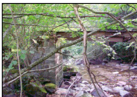
Restes du support de conduite
