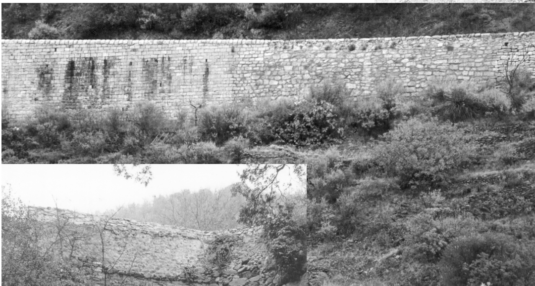
Quel parapet ! Quels travaux ! Entre Cattlar et Molitg
